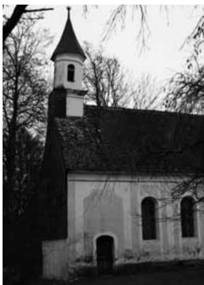
Das feuchte Mauerwerk der Kapelle von Seeseiten soll saniert werden. Kosten: rund 40.000 Euro, wovon den größten Anteil ein privater Gönner übernimmt.
