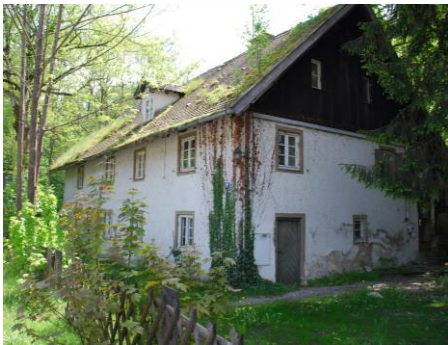
Das baufällige Mühlengebäude.
