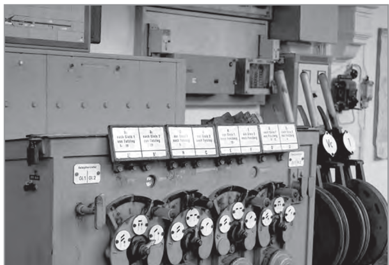
Das Krauss-Stellwerk von 1903 ist bis heute in Betrieb.
